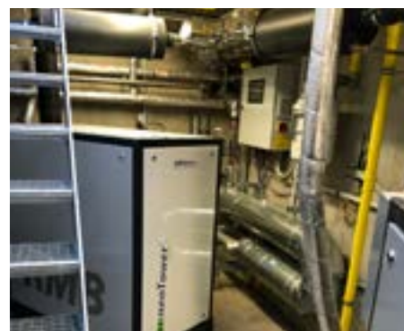
Der unsichtbare Technikraum ist über einen eigenen Zugang erreichbar.
