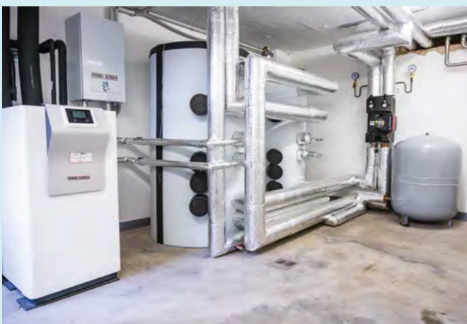
Blick in den Heizungskeller: Inneneinheit der Wärmepumpe (links) und die beiden Pufferspeicher (Mitte)
