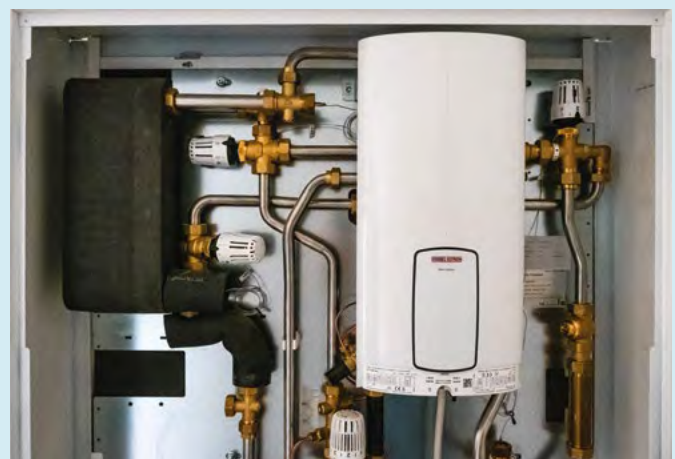
Blick in die Wohnungsstation 1: Der elektrische Durchlauferhitzer springt ein, wenn höhere Trinkwassertemperaturen benötigt werden.
